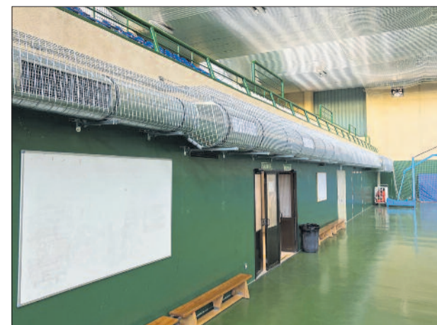
Sistema de calentamiento ambiental del polideportivo municipal.
